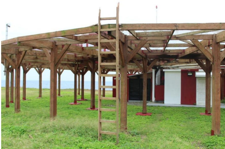
Fig. 5 – Imagen de la escalera con daños en la estación VOR MHRO.
